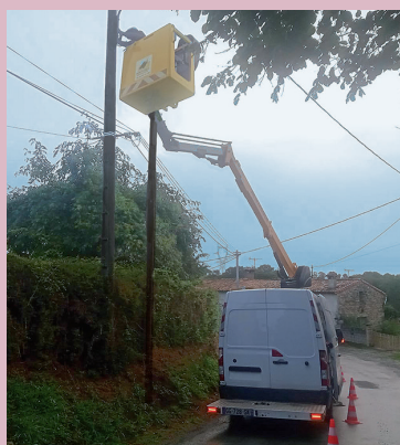
Éclairage public à LED, Lugné
